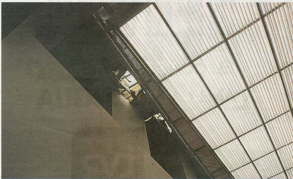
Aquesta és la forma com va quedar la part del sostre de la biblioteca Lambert Mata per on es fa filtrar l'aigua
