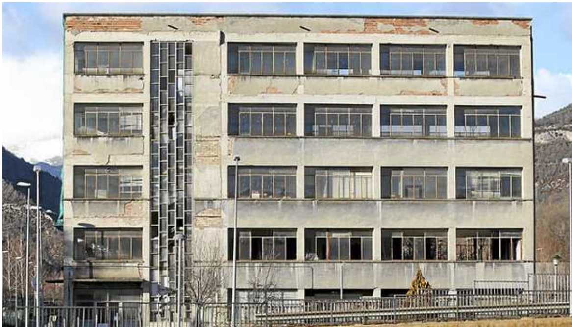
Imatge general de l'edifici de Comforsa feta des del terreny on ha d'anar ubicada la nova escola JORDI PUIG
