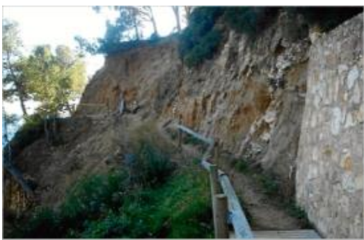
Tram del camí de ronda de Platja d'Aro afectat per les esllavissades.
