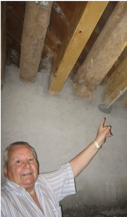
El regidor de manteniment d'Anglès, Bartomeu Carrillo, mostra una de les bigues afectades pels tèrmits Foto: J. FERRER.
