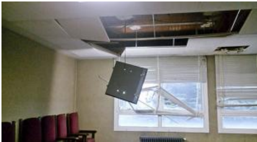
Part de les plaques del sostre han caigut i els vidres de les finestres estan trencats
