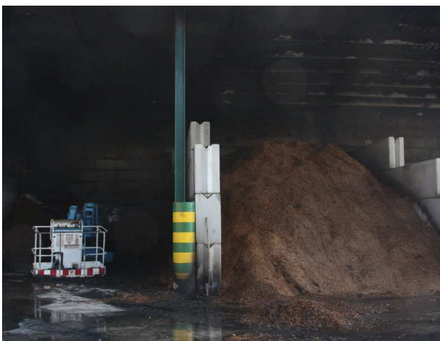
El cobert i la maquinària afectada durant l'incendi de Cassà Foto: LOURDES CASADEMONT / ACN.
