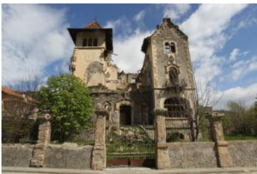
Estat actual de Can Roig. La rehabilitació suposarà refer les teulades i l'estructura, molt deteriorada Foto: Jordi Puig.
