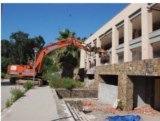
L'enderroc de l'edifici 'Armonía Resort', l'any 2010, executat pel municipi a instància d'una sentència del TSJC Foto: EL PUNT AVUI.
