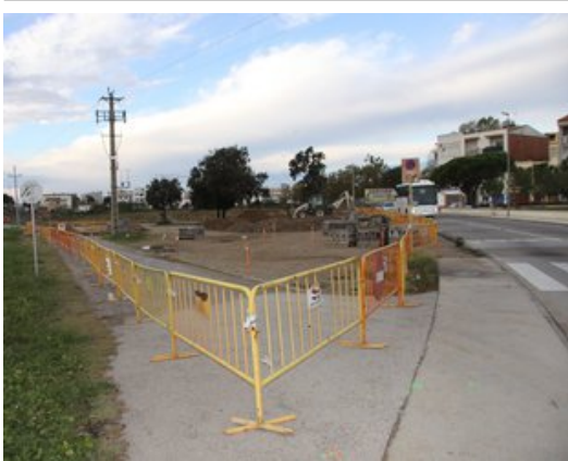
Tanques que delimiten la zona on s'han iniciat les obres de la nova rotonda a Roses Foto: EL PUNT/AVUI.
