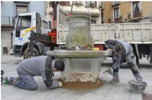
Uns operaris treballant en la instal·lació provisional del banc circular de la plaça Sant Eudald Foto: Jordi Puig.
