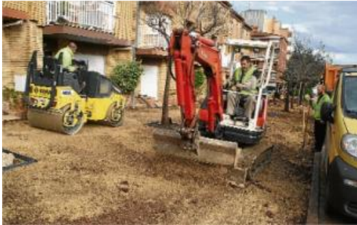
Operaris treballant ahir en les obres de remodelació del carrer Pare Claret, de Banyoles.
