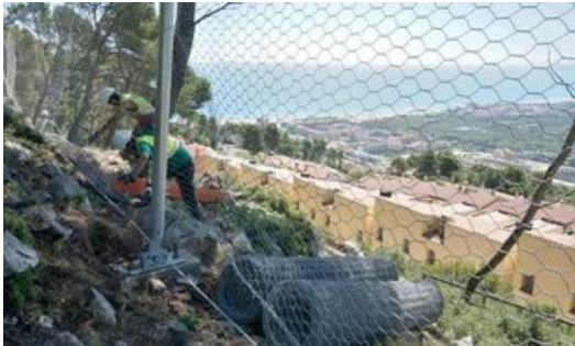
La instal·lació de les pantalles de protecció a Torre Moratxa. Foto: E. AGULLÓ.
