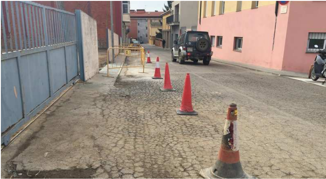
L'asfalt malmès a la part alta del carrer Migdia. El nou aparcament és darrera la tanca a l'esquerra de la imatgeFoto: J.N.
