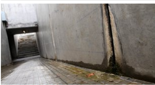
Imatge del mal estat del pas subterrani de l'estació d'Hostalric Foto: JOAN SABATER.
