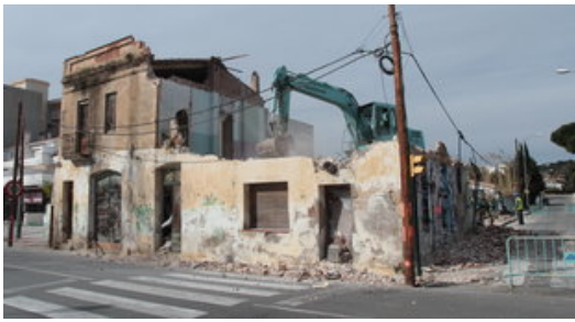
L'enderroc de l'antic edifici ,de Can Cornetes, ahir, a l'avinguda Platja d'Aro de s'Agaró Foto: E.A.
