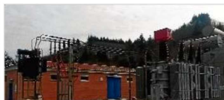
Una imatge de la subestació elèctrica d'Endesa a Sant Hilari
