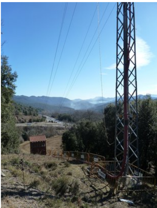
La companyia està duent a terme millores a la Garrotxa, com la dels transformadors de la Vall de Bianya. Foto: J.C.
