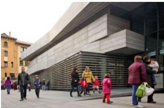
Les làmines de formigó estan a la part baixa de l'edifici. Ara s'estan fent obres perquè no caiguin Foto: Albert Llimós.
