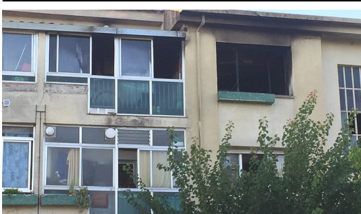
Exterior del pis afectat pel foc als bloc número 1 dels habitatges de Nostra Senyora de la Llum. Foto: AJUNTAMENT DE CALDES.
