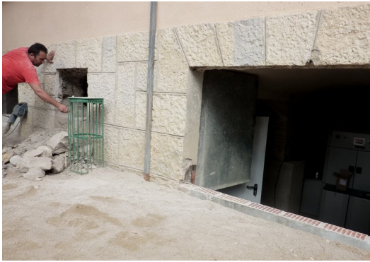
Un operari treballant en la instal·lació. A la dreta es veu una part de la caldera. Foto: R. E.
