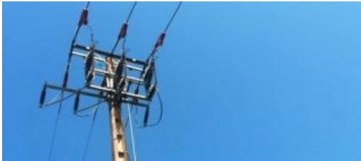
Instal·len proteccions a dues línies de Sarrià i Maçanet per evitar que les aus s'electrocutin
