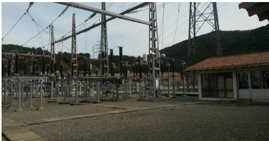
Una vista de la subestació que Endesa ha millorat per assegurar el subministrament al Ripollès. Foto: EL PUNTAUVI.
