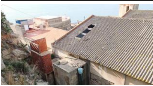
Roses alerta Costes del mal estat i material contaminant de la depuradora de marisc
