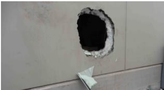
La paret lateral de la nau, on els lladres van foradar · X.V.
