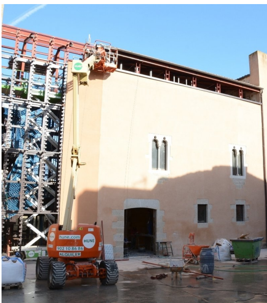
El castell de Calonge està en obres, en concret, s'està tancant la primera fase de la rehabilitació. Foto: EL PUNT AVUI.
