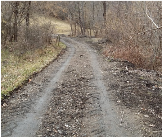
Una vista de la pista de Roques Blanques entre Ribes de Freser i Campelles, on es va produir l'esllavissada. Foto: J.C.
