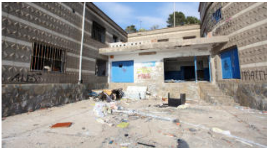
L'antiga depuradora de marisc de Roses acumula runa i deixalles a l'interior
