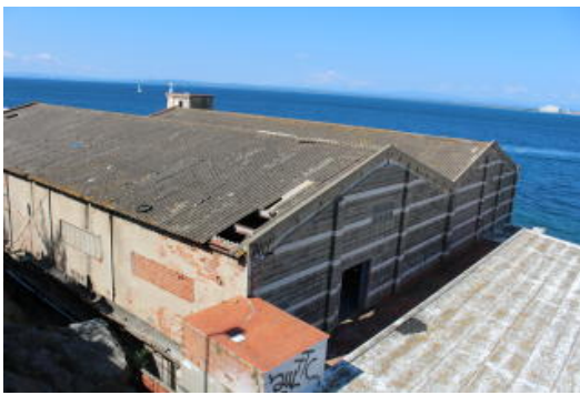
L'edifici, a primera línia de mar, es troba en estat ruïnós.
