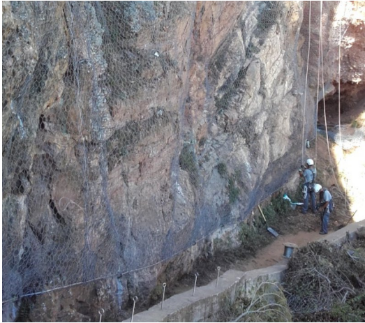
Operaris de Geotalud treballant en un dels trams del camí de Ronda de l'Illa Roja Foto: EPA.
