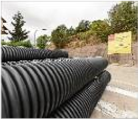
S'ha d'instal·lar una canonada.
