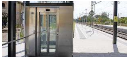
Els ascensors ja estan operatius. Carles Colomer
