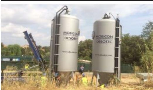
Els filtres de carbó actiu, que depuren 100 metres cúbics d'aigua per hora.
