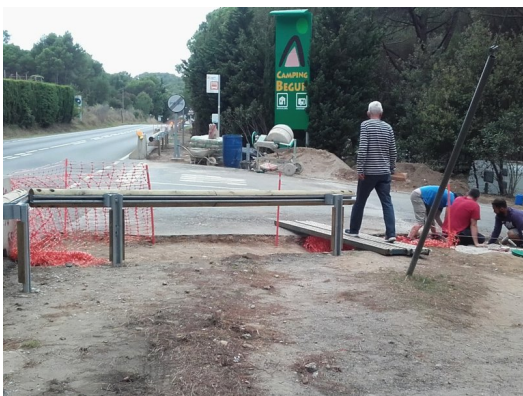
Els treballs, aquesta setmana, a l'alçada del càmping Begur Foto: EL PUNT AVUI.
