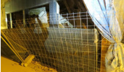
Un edifici en procés d'enderroc s'ensorra parcialment a Blanes
