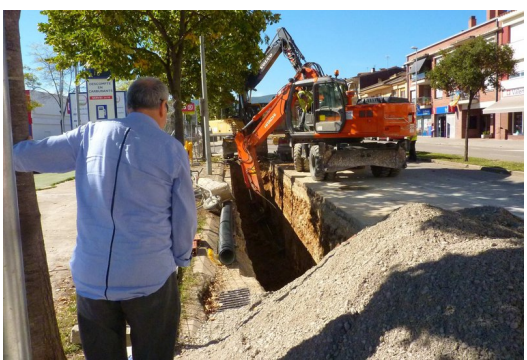
Les obres del col·lector del 2013, any a partir del qual el problema s'ha agreujat. Foto: R. E.
