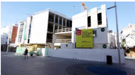
L'obra de la SUF de Roses es modifica pel perill detectat per als edificis del costat
