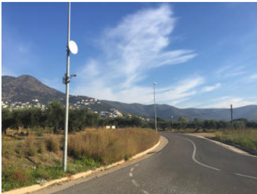
Les càmeres ja estan instal·lades.
