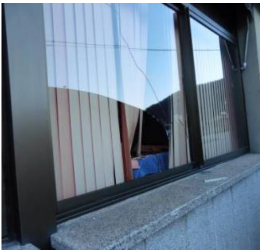
Els vidres trencats al finestral del casal.
