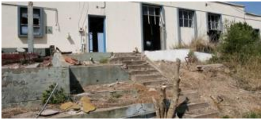
Imatge d'arxiu de les antigues instal·lacions de la base Loran-C, a l'Estartit.
