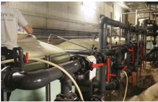
La Piscina de Roses millora la filtració
