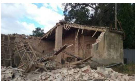
Caiguda del mur d'una nau a Calonge
