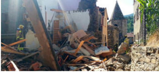
Estat en el que ha quedat la casa.
