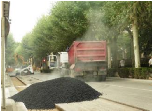
Les obres de la millora del paviment de l'entorn de la plaça Clarà. DdG
