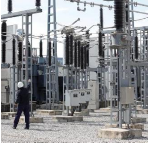
Imatge de la subestació elèctrica de Mas Xirgu, Girona.
