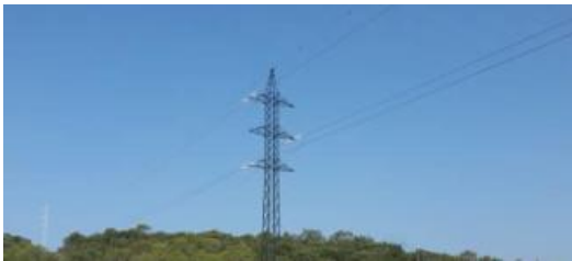
Torre d'alta tensió a Juià que enllaça la línia fins a Bellcaire.
