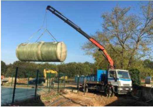
Sant Jaume de Llierca instal·la un dipòsit de 32.000 litres d'aigua
