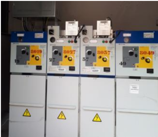
Les noves cabines de telecomandament.
