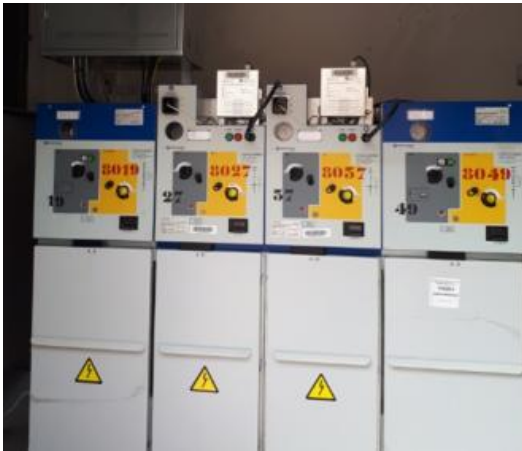
Les noves cabines de telecomandament.
