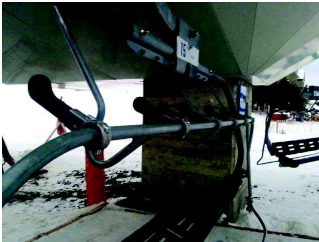
Sistemes de seguretat als remuntadors. Foto: FGC
