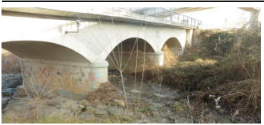
Pont de l'Hostal del Sol sense aigua
